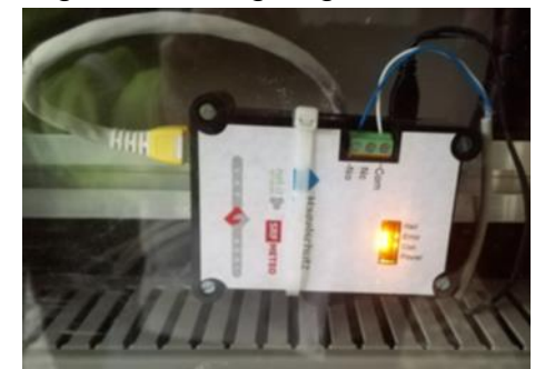
Signalbox fertig angeschlossen
