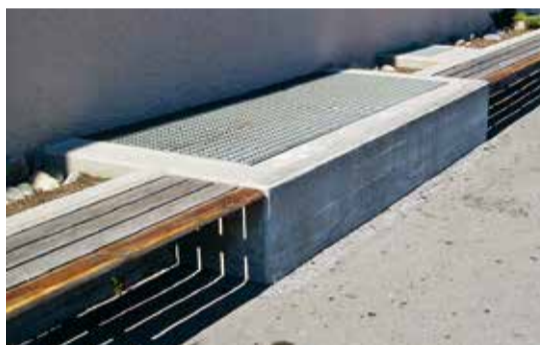
...oder die Erhöhung des Lichtschachts verhindert das Eindringen von Wasser in die Kellerräume
